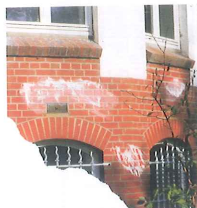
Salpeter am Mauerwerk
