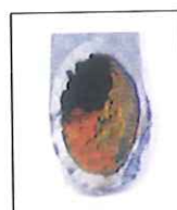
Kalk-/Rostverkrustung im Härtebereich 2 + 3
